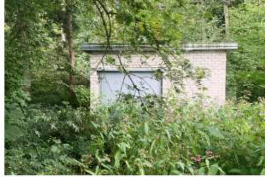
3 pav. ESO elektros transformatorinė TRN-33.
